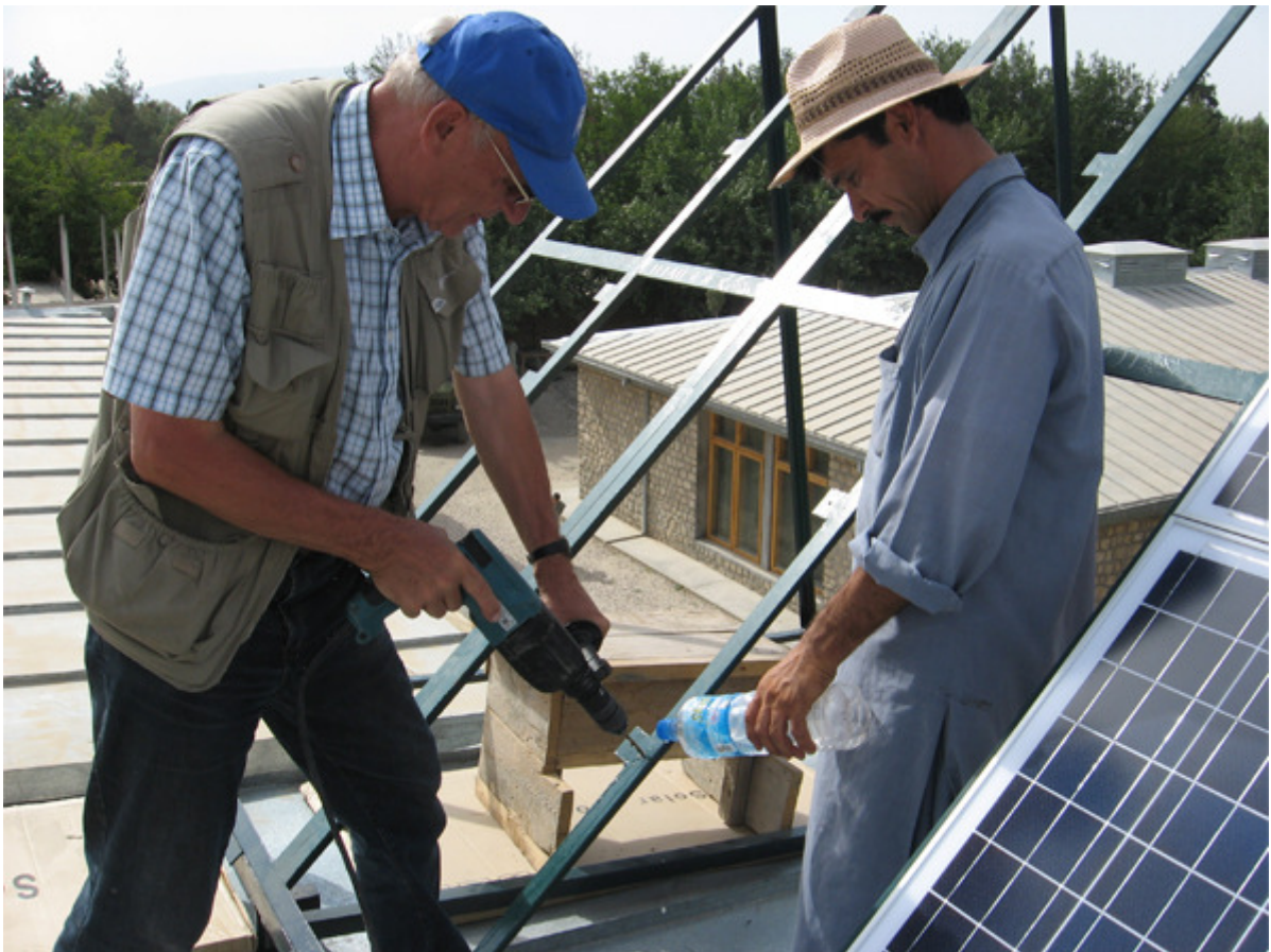
Montage der Solaranlage durch Hannsgeorg Preuß und seinen afghanischen Kollegen auf dem Dach des Teacher-Training-Colleges in Taloqan, Afghanistan
